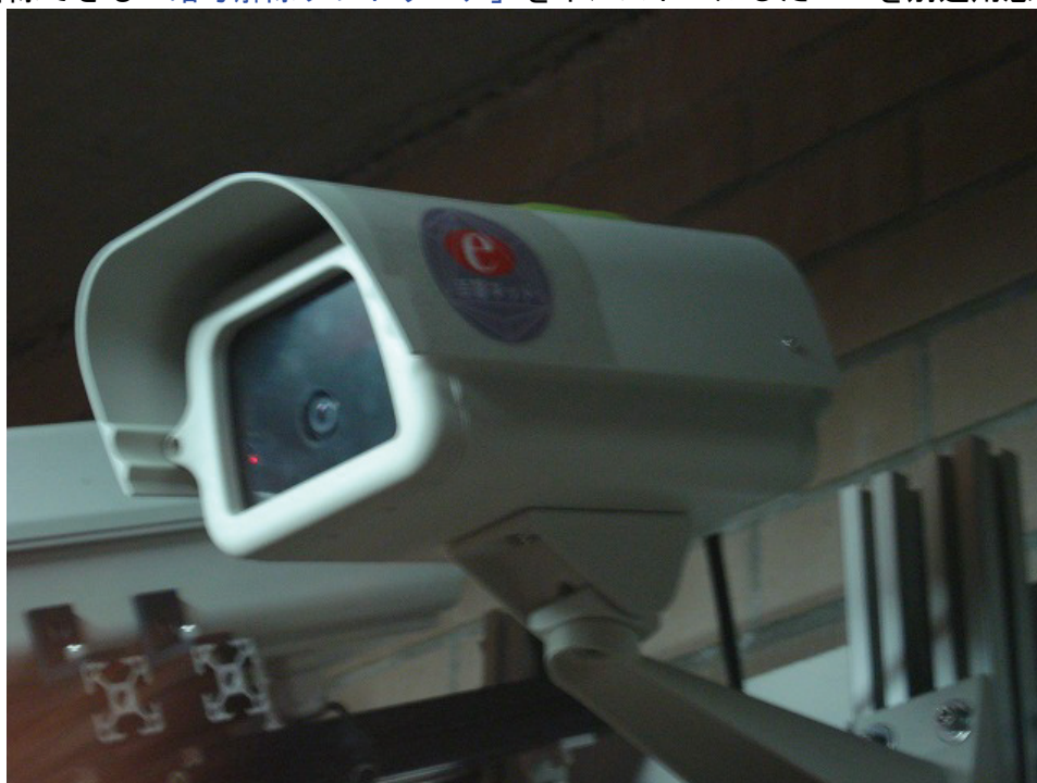
図1 屋外設置の様子
