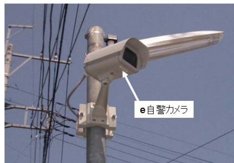
(b) e自警カメラの設置状況
