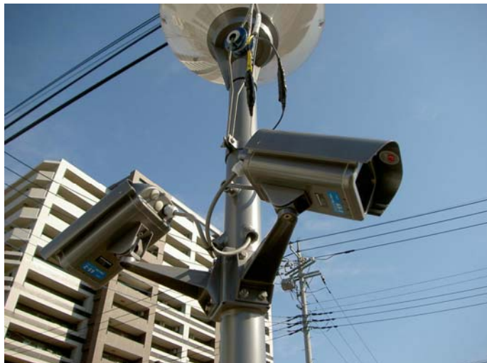
防犯灯ポールごとにカメラ2台を設置
